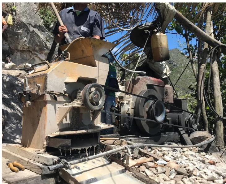
Figura 17- Visão frontal do moinho em operação e sendo alimentado pelo operador
